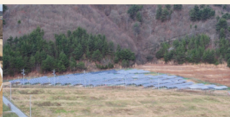
グリーンパーク都路発電所 (449kW)
