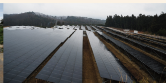
棚倉堂ノ沢発電所 (2678kW)
