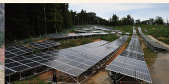
矢吹中丸発電所 (739kW)
